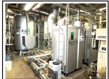
ひと夏かけて、40年ぶりにボイラーも新しく！(これがボイラーです)
