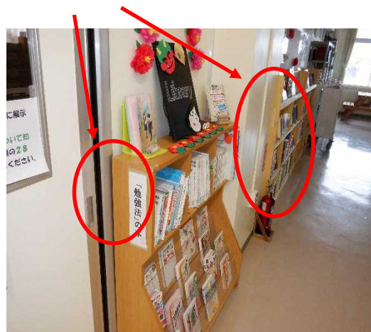
棚固定（図書館前廊下）
